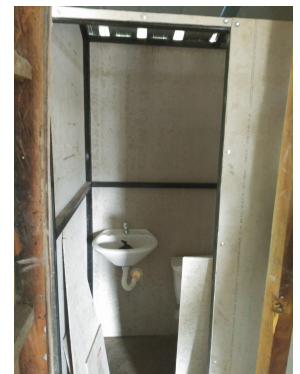
Detalle de uno de los baños aportados por el PUR (Periqueame)
